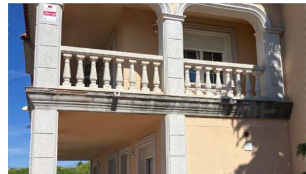
VISTA DEL ESTADO DE LAS CORNISAS
